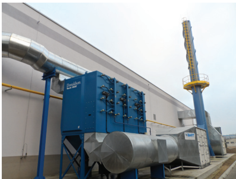
FOT. 1 Układy filtrów powietrza wraz z centralami wentylacyjnymi
