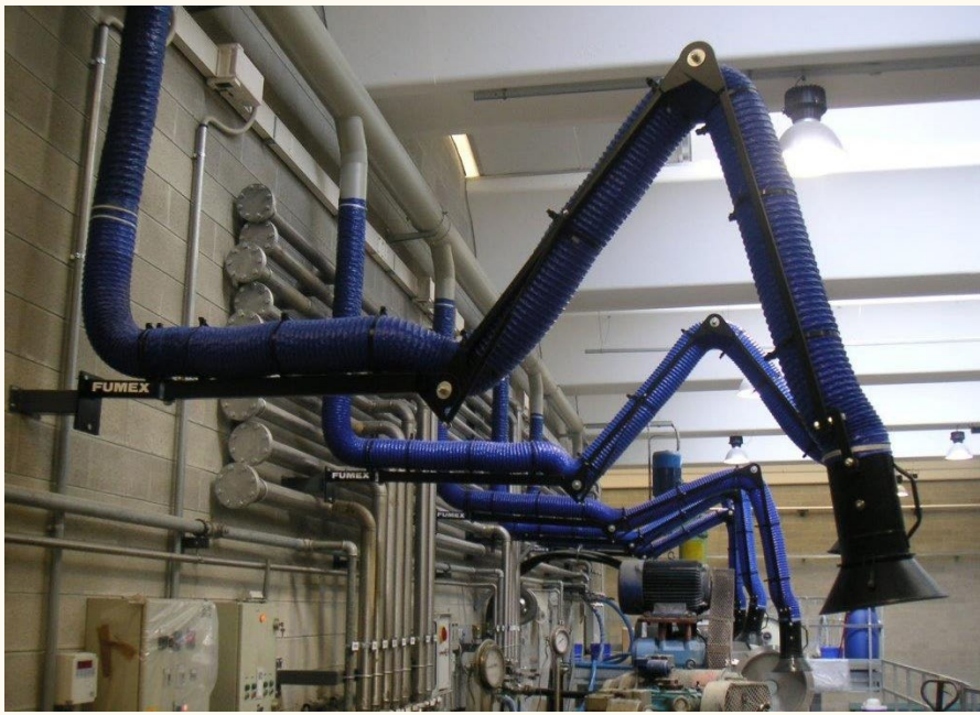
FOT. 4 Instalacja wentylacji wielostanowiskowej
