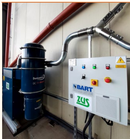
FOT. 2 Przykład rekomendowanego przez firmę BART rozwiązania filtrowentylacyjnego dofinansowanego przez ZUS
