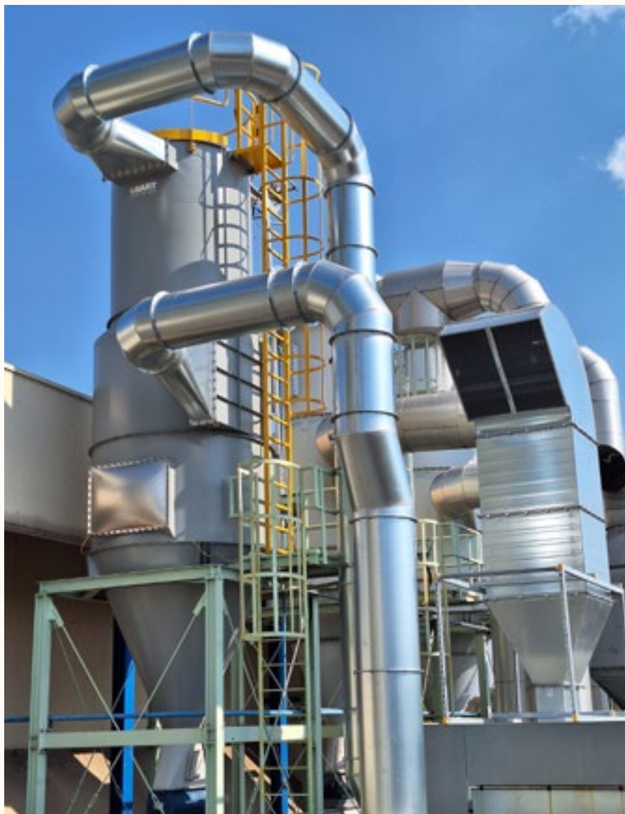
FOT. 1 Instalacja odpylająca na stanowisku rozładunku biomasy leśnej dla jednej z polskich elektrociepłowni
